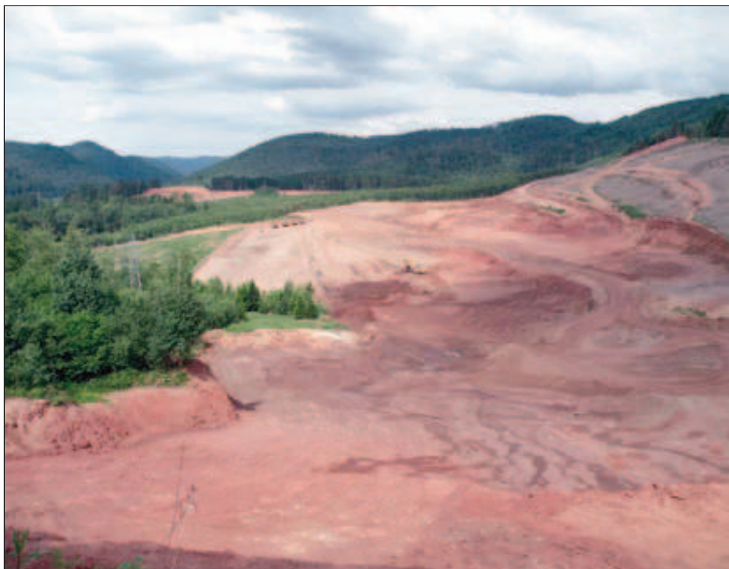
Du haut de la route des Bannes, la vue est impressionnante. Là où s'étendait il y a encore deux ans la forêt, les engins de terrassement s'activent pour atteindre le trapp.
